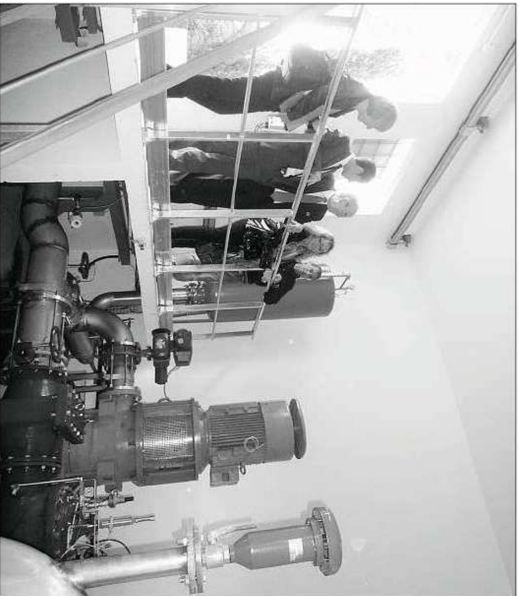
Les élus (David Lisnard, président du Sicasil, et le maire Alain Gumiel) lors de la visite au réservoir des Ames de Vallauris, où a été installée la première microcentrale électrique.
